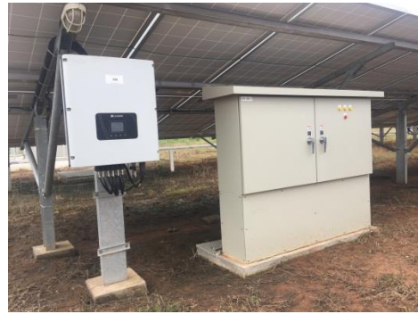
เครื่องแปลงกระแสไฟฟ้า (Inverter) / DC Combiner Box
