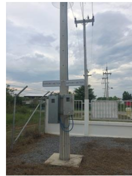
มิเตอร์วัดจำนวนหน่วยไฟฟ้า (Meter)
