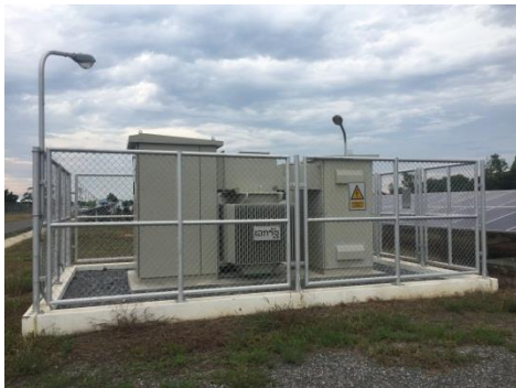
หม้อแปลงไฟฟ้า (Transformer)
